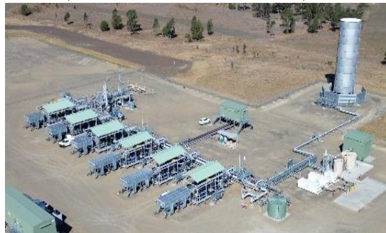
〈신규 가스처리시설 3호기 전경〉
